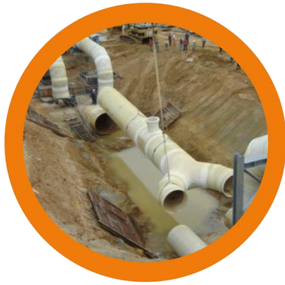
Tuberías en GRP
