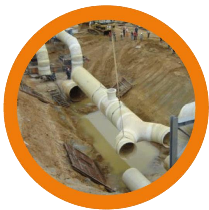
Tuberías en GRP
