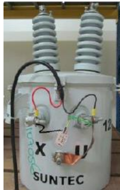
Figura 1. Conexión en el transformador del cable de alimentación del equipo de control
