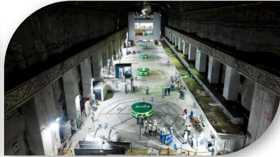
Casa de máquinas zona Norte Unidades 1 a la 4 (300 MW c/u)
