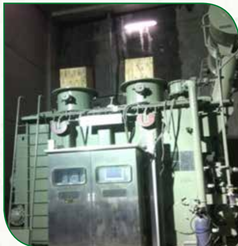
Transformador de potencia.
