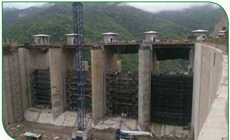
Compuertas radiales del vertedero.
