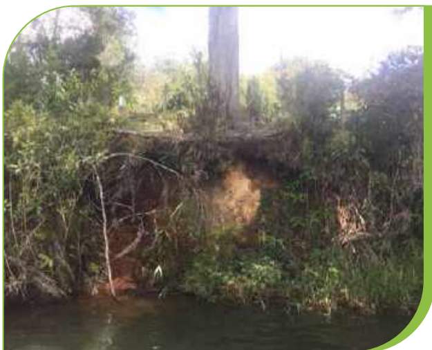
Imagen 3. Taludes verticales a causa de la erosión.
