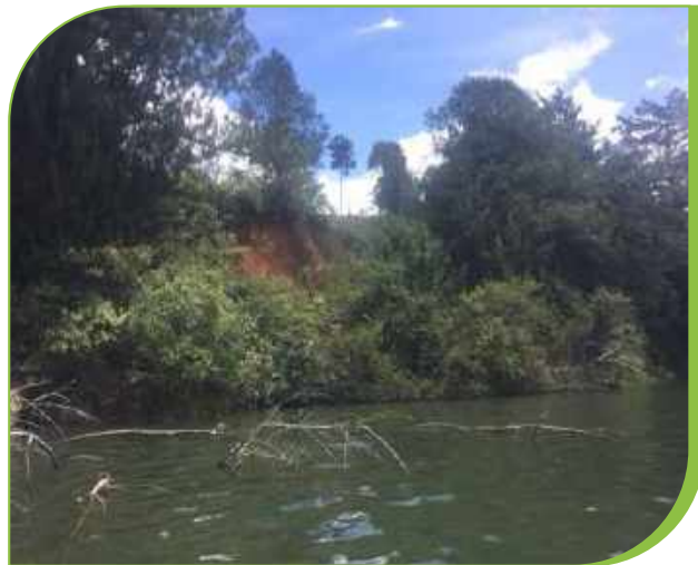
Imagen 2. Material vegetal removido por deslizamiento del talud.
