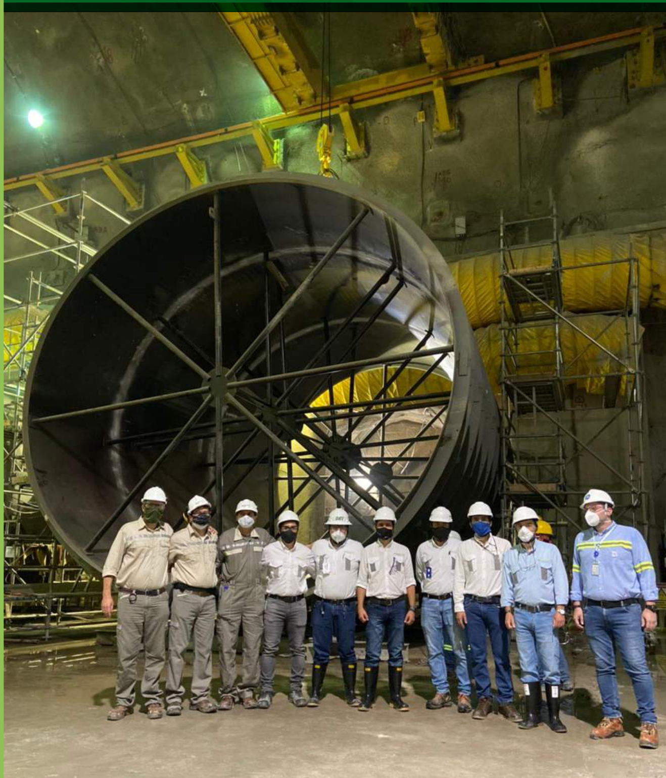
Personal técnico que participó en la instalación de virolas que conforma gran parte del tubo de aspiración de la unidad No. 1
