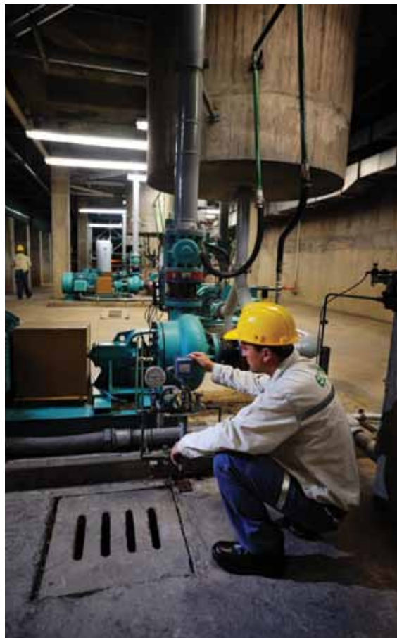
Planta de tratamientos de aguas residuales San Fernando
