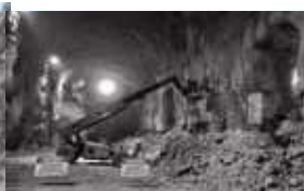
Así se ve Casa de Máquinas 14
