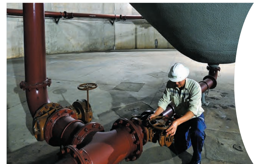
• Tanques de digestión anaeróbica planta San Fernando.
