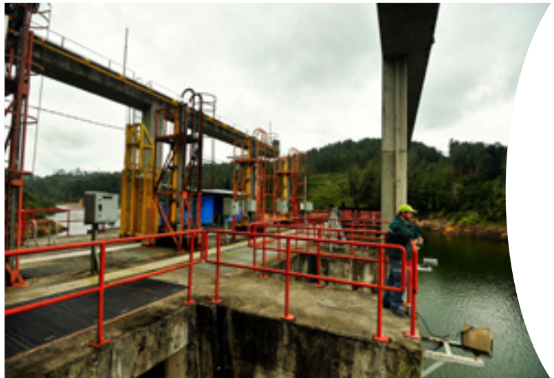
● Torre de captación Rio Grande II.
