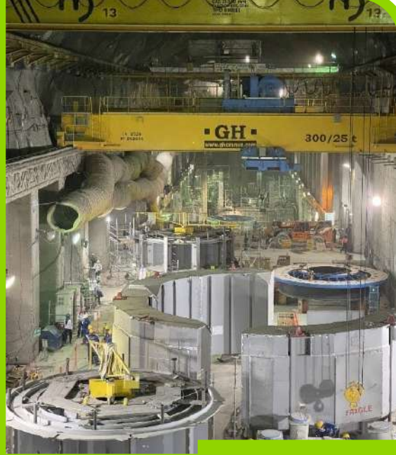
Rotores y estator de las unidades de generación.
