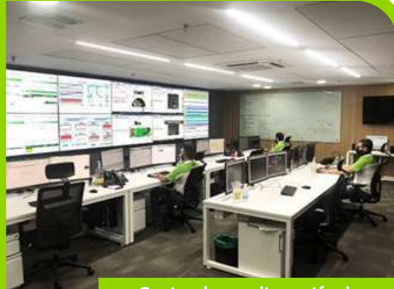
Centro de monitoreo técnico (CMT) Edificio Campamento Tacuí – Cuní - Hidroituango.
