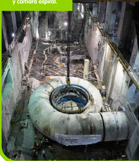
Anillo estacionario y cámara espiral.
