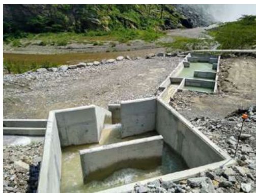
Sistema de sedimentación para el tratamiento de las aguas residuales no domésticas
