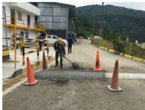
Construcción de un resalto para la reducción de velocidad de los vehículos
