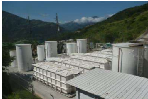
Planta de tratamiento de aguas residuales domésticas, campamento Villa Luz
