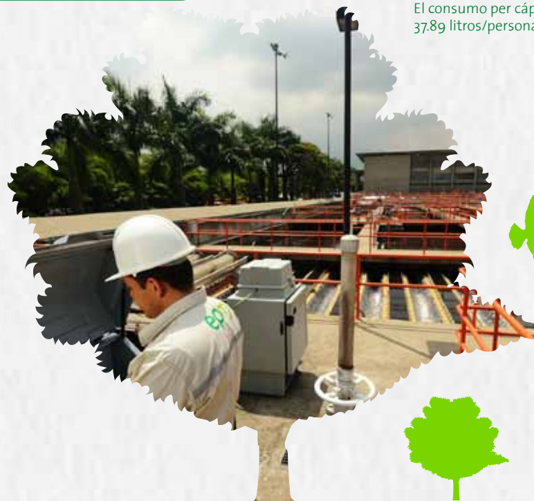
Planta de tratamiento de aguas residuales San Fernando
