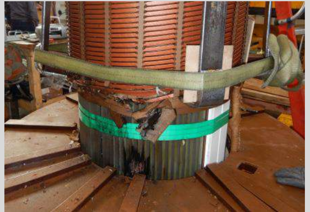
Falla TRF1 230/44 kV subestación Malena
