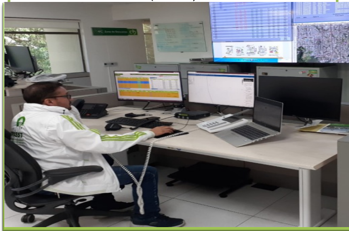
Centro Local de Distribución (CLD)
