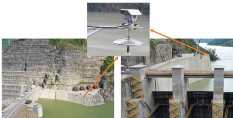
Figura 2-17. Radar Vaisala, nivel embalse Proyecto Hidroeléctrico Ituango.
