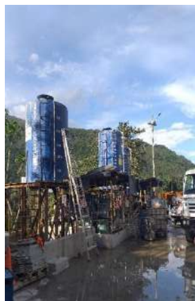
Fotografía 2-41 Tanques de almacenamiento de resina.
