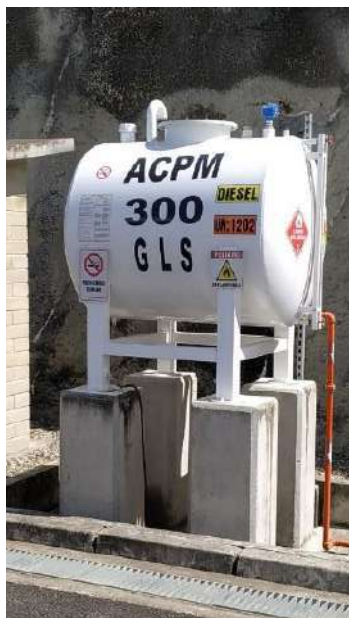
Fotografía 2-24 Tanque de almacenamiento de diésel.
