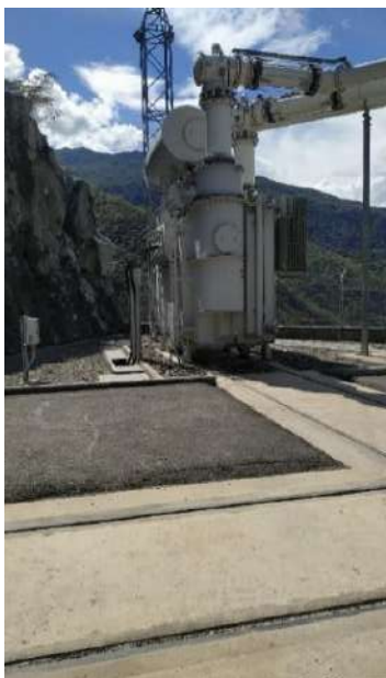
Fotografía 2-23 Transformador de potencia.
