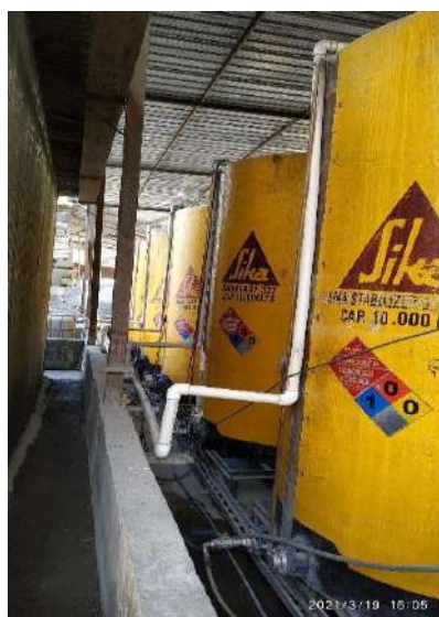
Fotografía 2-43 Dique de contención aditivos.
