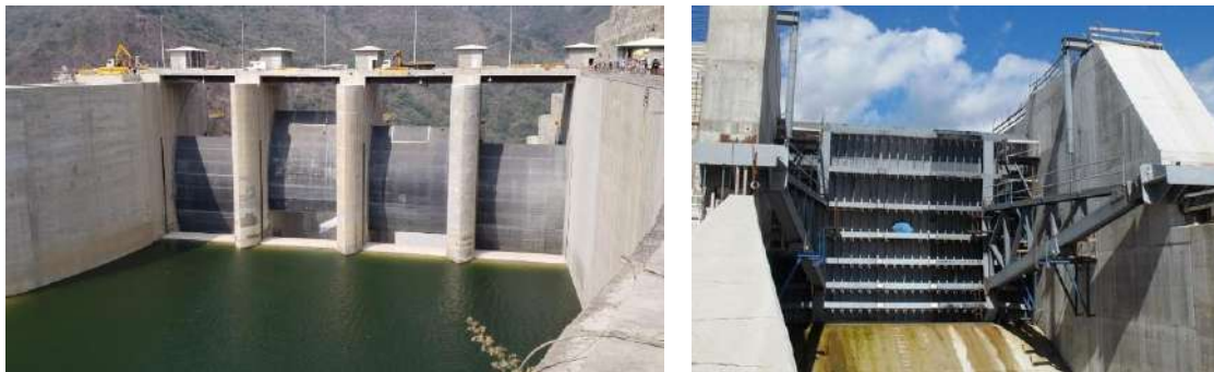
Figura 2-204 Compuertas radiales de vertedero - Vistas frontal y posterior.
