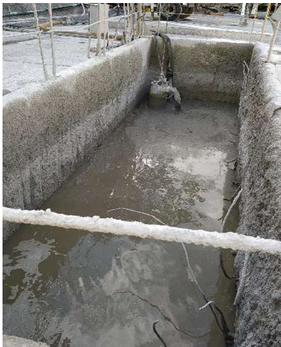
Fotografía 2-44 Tanque sedimentador planta de concretos.
