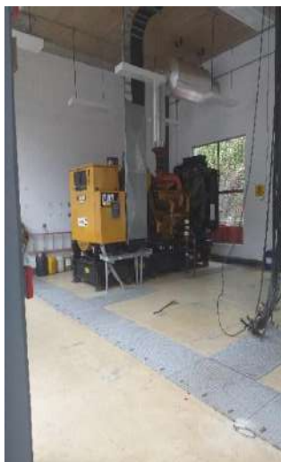
Fotografía 2-26 Planta diésel campamento Tacuí-Cuní.
