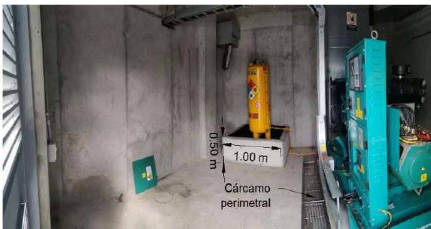
Fotografía 2-18 Planta diésel y tanque de almacenamiento.
