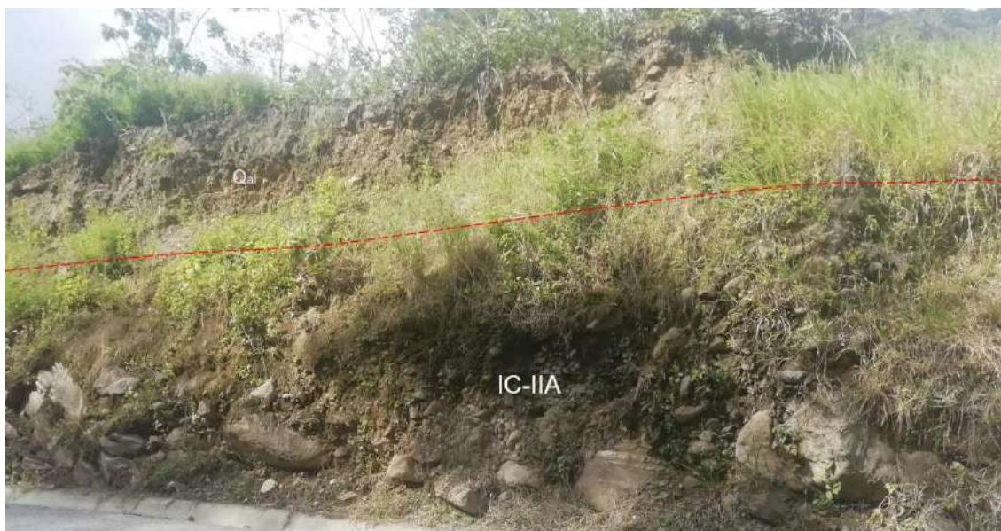
Fotografía 2-3 Horizonte IC-IIA en la margen derecha del río Cauca, vía Puerto Valdivia – Sitio de Presa, sector quebrada Ticuitá, tomada en octubre de 2019.
