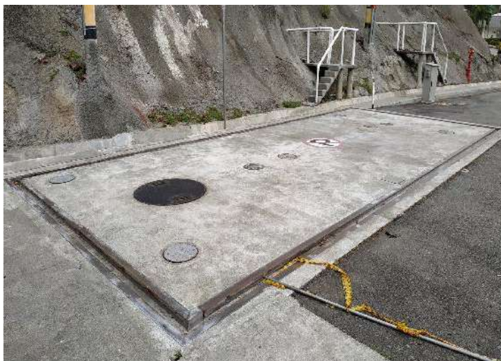
Fotografía 2-27 Tanque de almacenamiento diésel.
