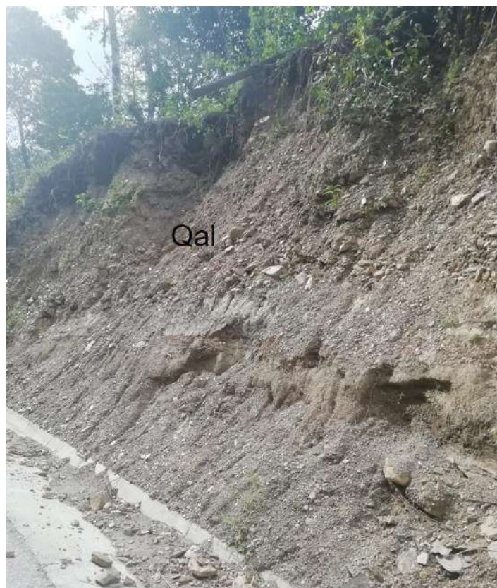
Fotografía 2-5 Depósito aluvial en la margen derecha del río Cauca, vía Puerto Valdivia – Sitio de Presa, sector quebrada Ticuitá, tomada en octubre de 2019.
