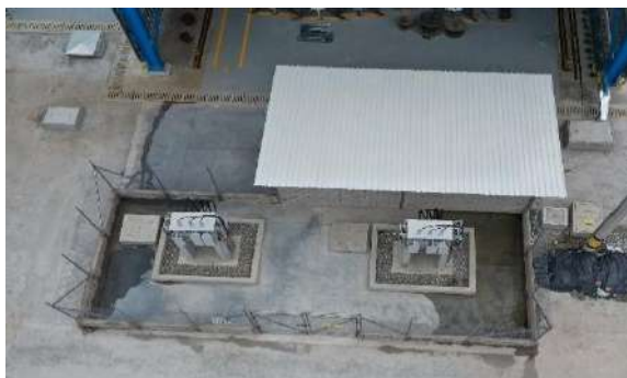
Fotografía 2-16 Transformadores Taller ATB.
