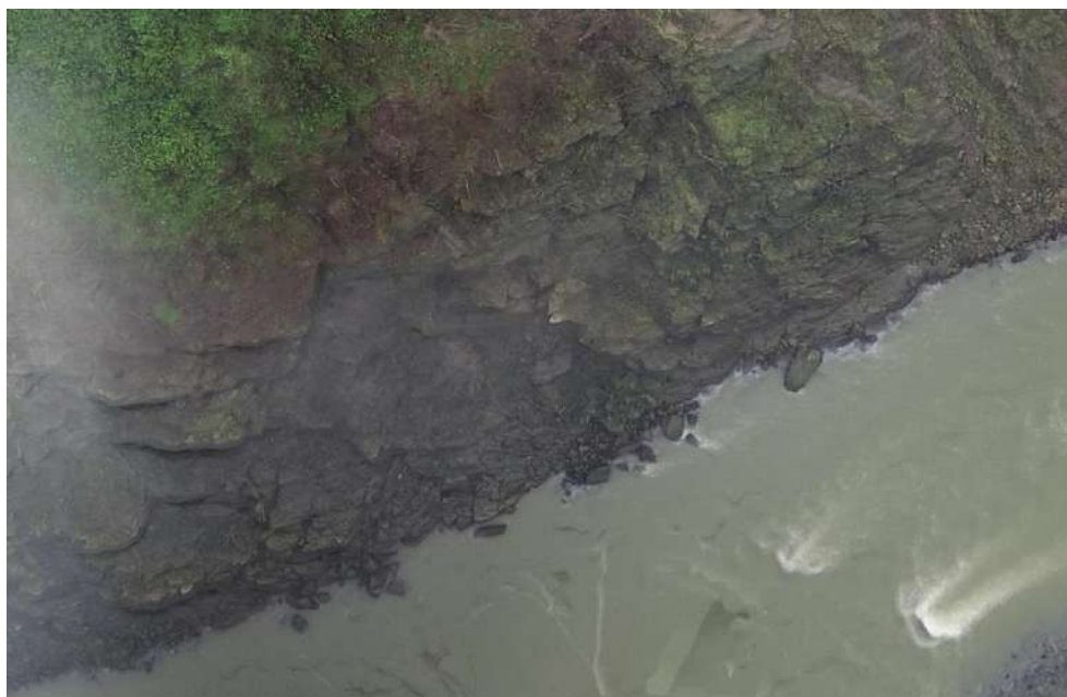
Figura 2-144 Presencia de roca con horizonte de meteorización IIB en la parte media y baja del talud (noviembre 2020).
