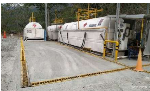
Fotografía 2-28 Estación de combustible, tanques de almacenamiento.
