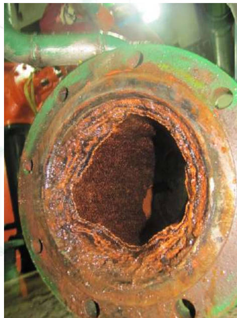
Tubería sin lavar
