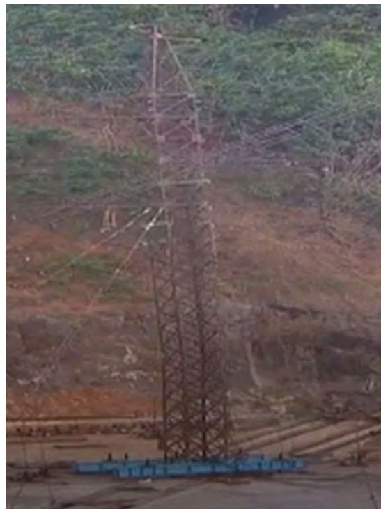
Figura 8. Torre AN-R: Falla de retenidas y falla en un Montante en prueba destructiva.
