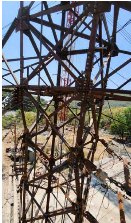
Figura 9. Torre CN-R: Fallo de montantes en prueba destructiva.
