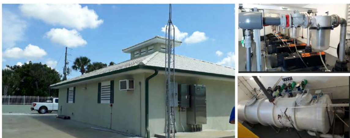
Figura 4. Aspectos generales de la Estación de vacío #59 en Charlotte County, Estados Unidos.
