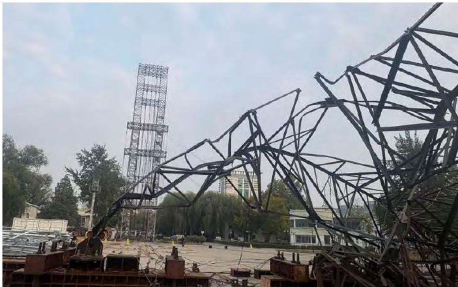
Figura 10. Torre B: falla en la conexión mediante mecanismo de bloque cortante.
