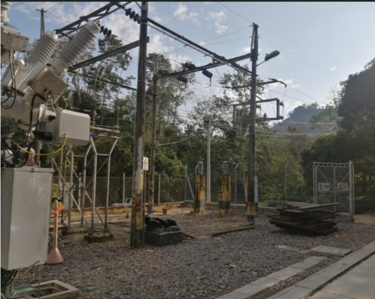
Castilla 110 kV – 44 kV
