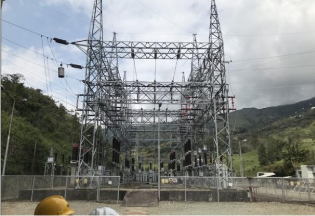
Rionegro 110 kV – 44 kV
