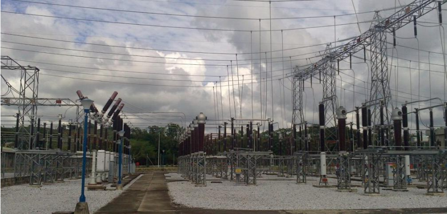
La Toyosa 44 kV
