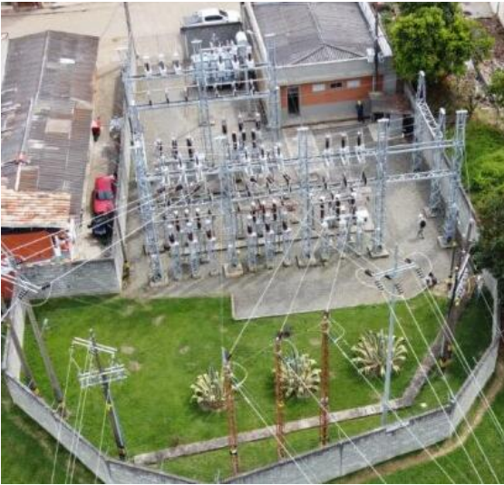
La Cruzada 110 kV – 44 kV
