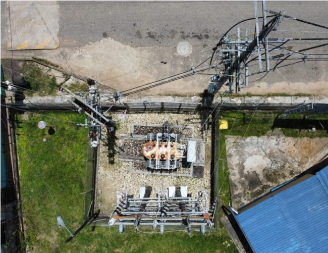
La Fe 44 kV
