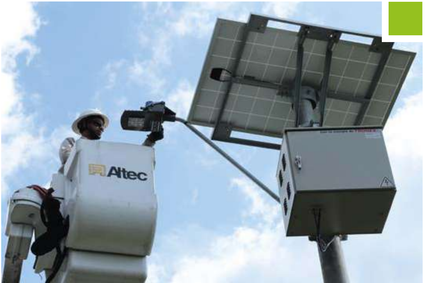
Piloto de alumbrado público solar - Cerro El Volador, Medellín
